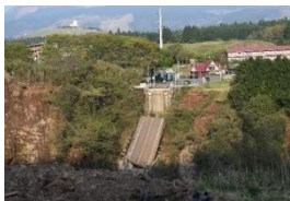
旧阿蘇大橋の橋桁 (南阿蘇村)
