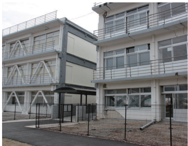
▲耐震補強の有無による被害の差が観察できる一号館
